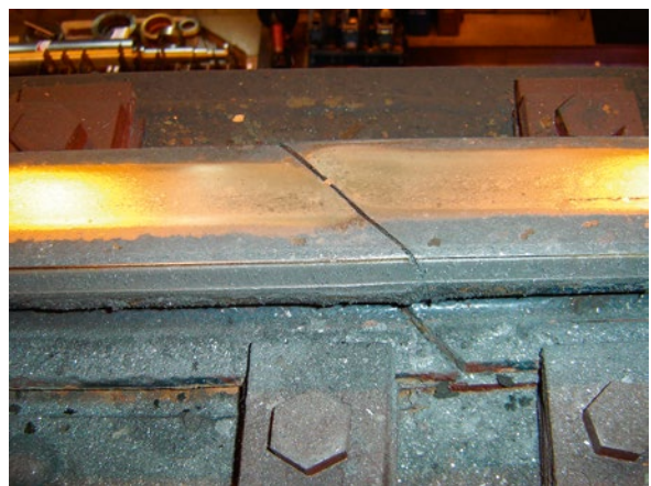
Degradacja torowiska suwnicy
